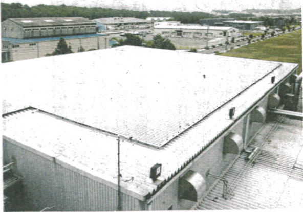
西薩クリーンサンセット事業協同組合の工場の屋根に取り付けられた太陽光発電パネル
