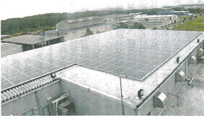
西薩クリーンサンセット事業協同組合の屋根に設置された太陽光発電設備
